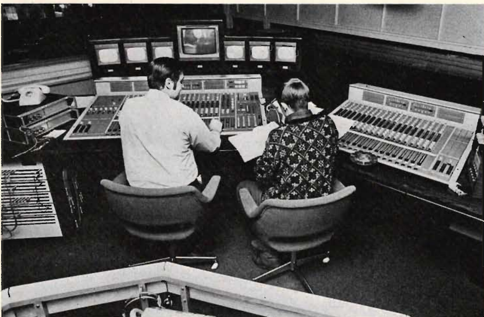
Fig 1 b. Ljudkontrollutrustning i Sveriges Radios färg-TV-studio nr 1. Kontrollborden uppbyggda enligt Sveriges Radios regelblocksystem.
