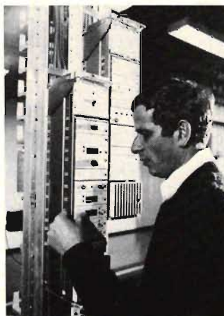
◀ Fig 3. På ändstationerna Frankfurt/Ginnheim och Oberursel sker omvandlingen från elektriska till optiska signaler och vice versa. Bilden visar utrustningarna, sändare och mottagare för den optoelektroniska omvandlingen liksom fjärrmatnings- och övervakningsanordningarna. Tack vare den moderna teknologin tar enheterna – i förhållande till det stora informationsflödet – mycket liten plats.
