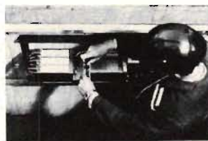
Fig 1. Utmed den 15,4 km långa fiberoptiklinjen i Frankfurt är mellanregeneratorer i underjordiska huvvmuffar utplacerade med ca 5 km mellanrum. Bilden visar sådana regenerators och till höger därom omriktaren för fjärrmatning.
