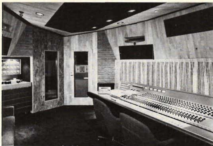
Fig 6. Mixningskonsolen med Neve's Necam-automatinsats som tidigare beskrivits i RT i anslutning till glimterna från Glenstudio i Djursholm.
