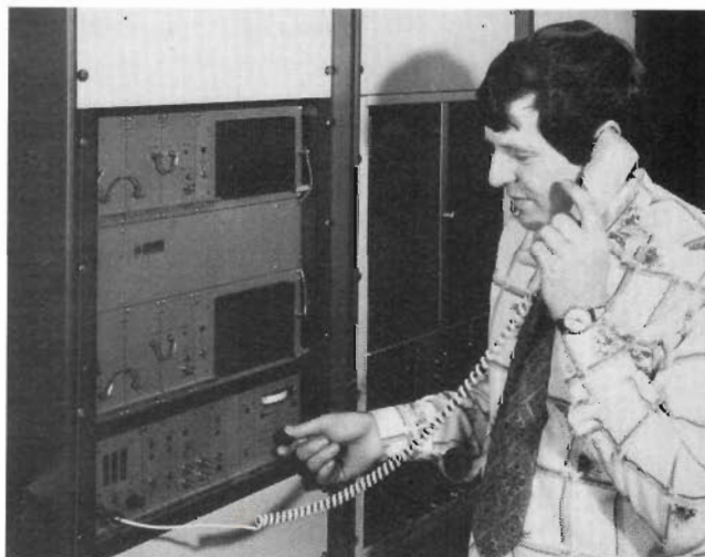
Fig 16. Bilden visar Plesseys radiolänkutrustning PRD 1100MKII som påminner om den som används vid kommunikationen mellan England och plattformarna i Nordsjön.
