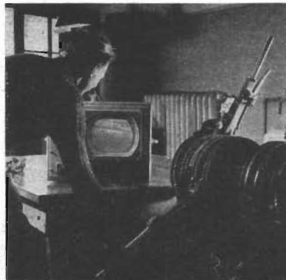
Fig. 10. En TV-anläggning i ett ställverk ger växlingspersonalen värdefulla kontrollmöjligheter. TV-apparatur: Philips.
