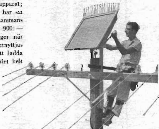
Detta är ett solbatteri under uppmontering på en telefonstolpe. Batteriet omfattar 432 kiselceller, indränkta i olja och täckta av glas. ( Bell Telephone Laboratories. )
