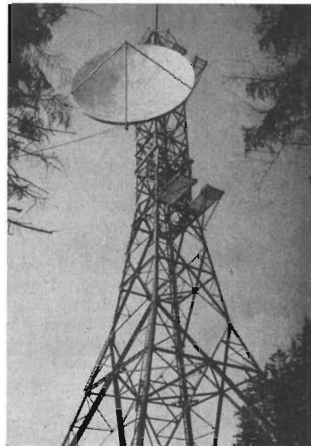
Montering av en av de stora parabolspiegeln som utnyttjas i troposfärspridningsförbindelsen Berlin—Harz.
