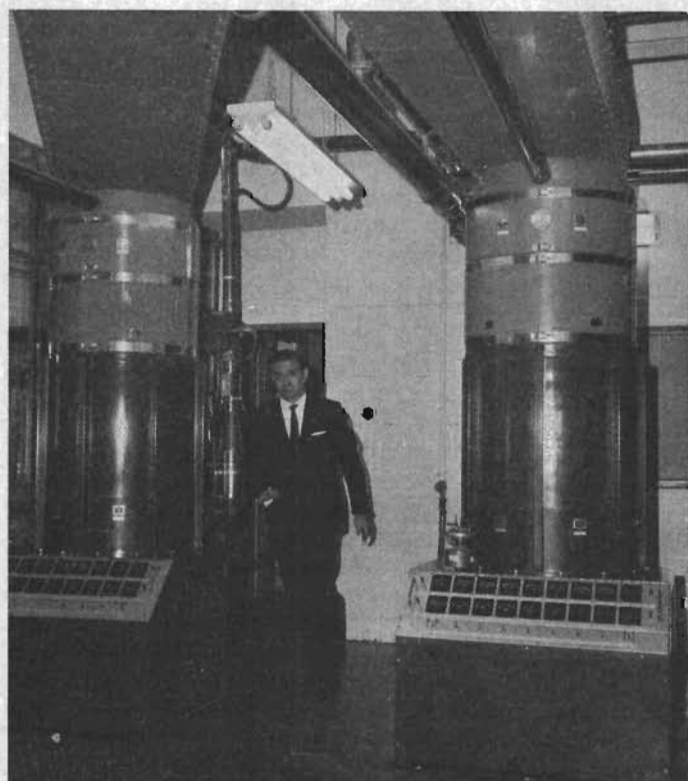
Fig 2 De båda slutstegen i TV-sändaren i Madrid, belägen på Navacerrada, ger tillsammans 50 kW för bildbärvägen. Ett tredje, på liknande sätt uppbyggt slutsteg, ger 25 kW för ljudbärvägen. Genom att man har 6 ggr antennvinst, se fig. 3, erhålles 300 kW erp från stationen.
