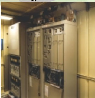
Underjordisk FTN-anläggning med en tele- och en elverkscontainer
