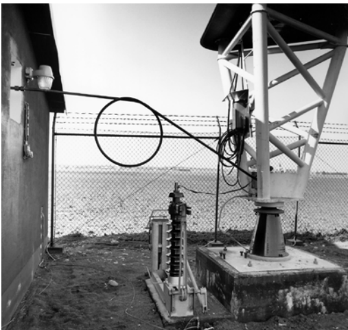
Fotisolator, matarkabel jordningsbrytare
