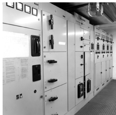
Manöverskåp Nät- och reservkraft
