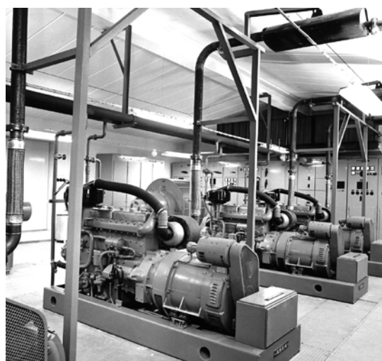
Reservkraft 3 dieselgeneratorer på vardera 355 kVA
