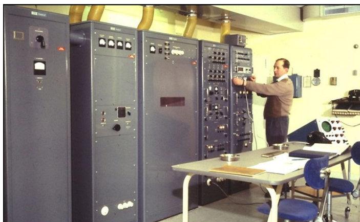
Sändarrummet med Ing Noaksson under utprovning
