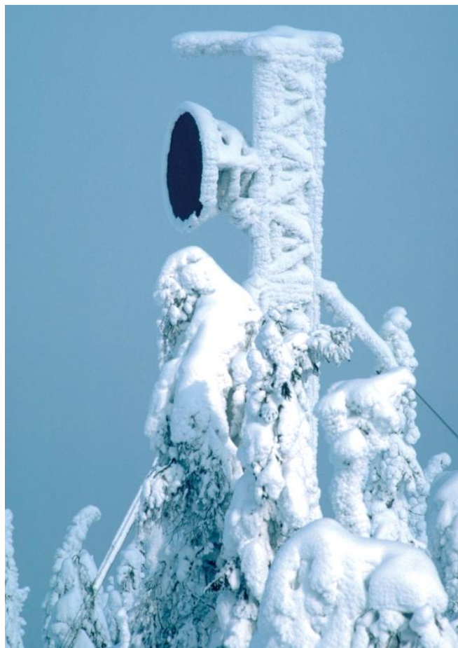
Figur 20: Radiolänkmast med parabol (Foto: Försvarets bildbyrå)
