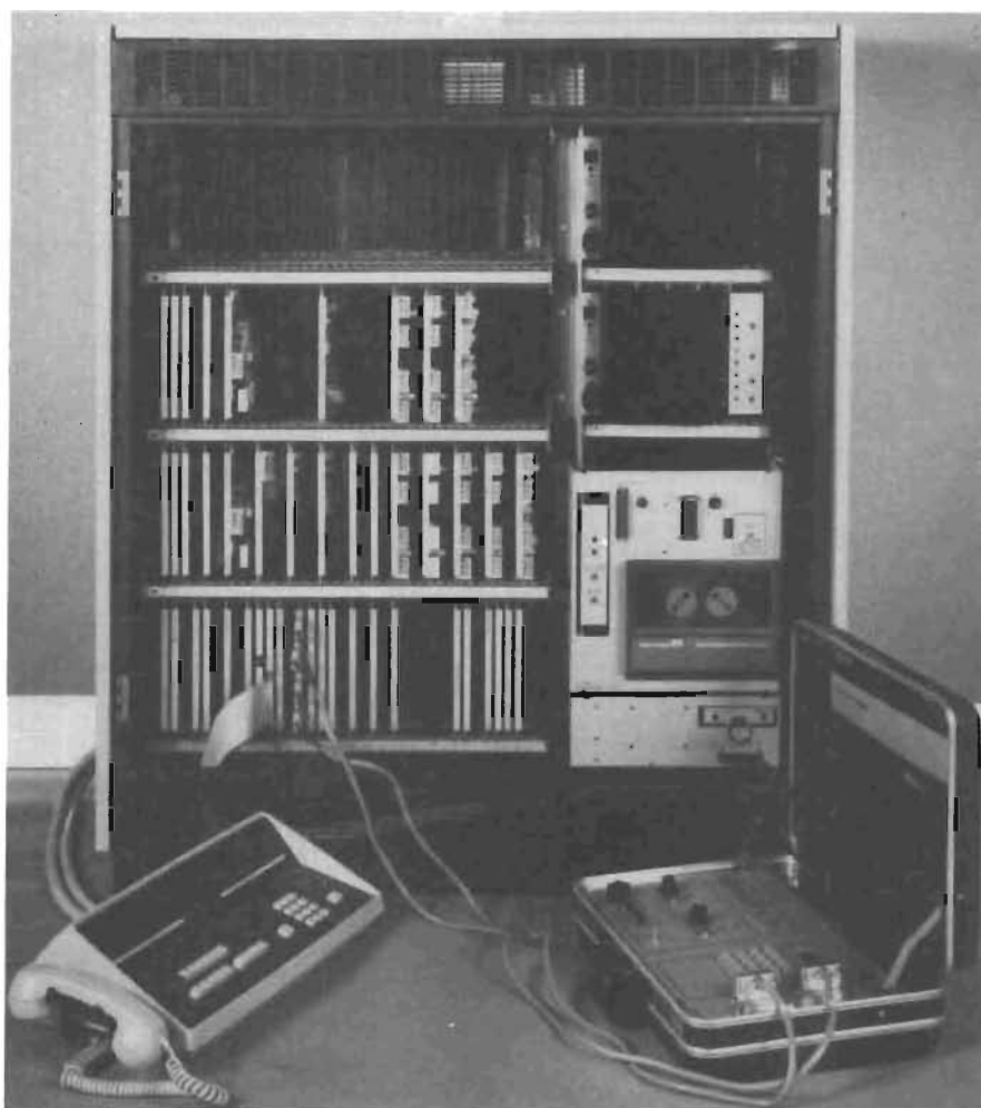
Bild 15. Abonnentväxel GTD 120, stativ
