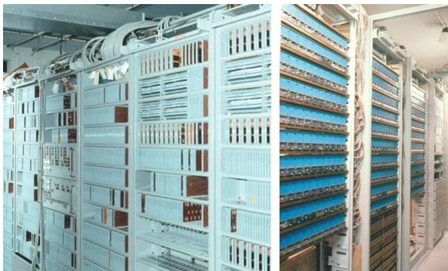
Figur 50: AKE-129, den första programminnesstyrda telefonväxeln i FTN var i drift i ATL 1969-1994 (Foto: Reinhold Carlsson, CVA)
