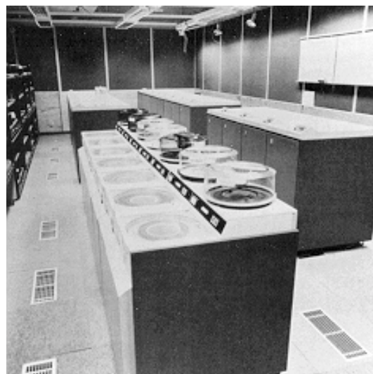
Datorhallen vid Försvarets datacentral
