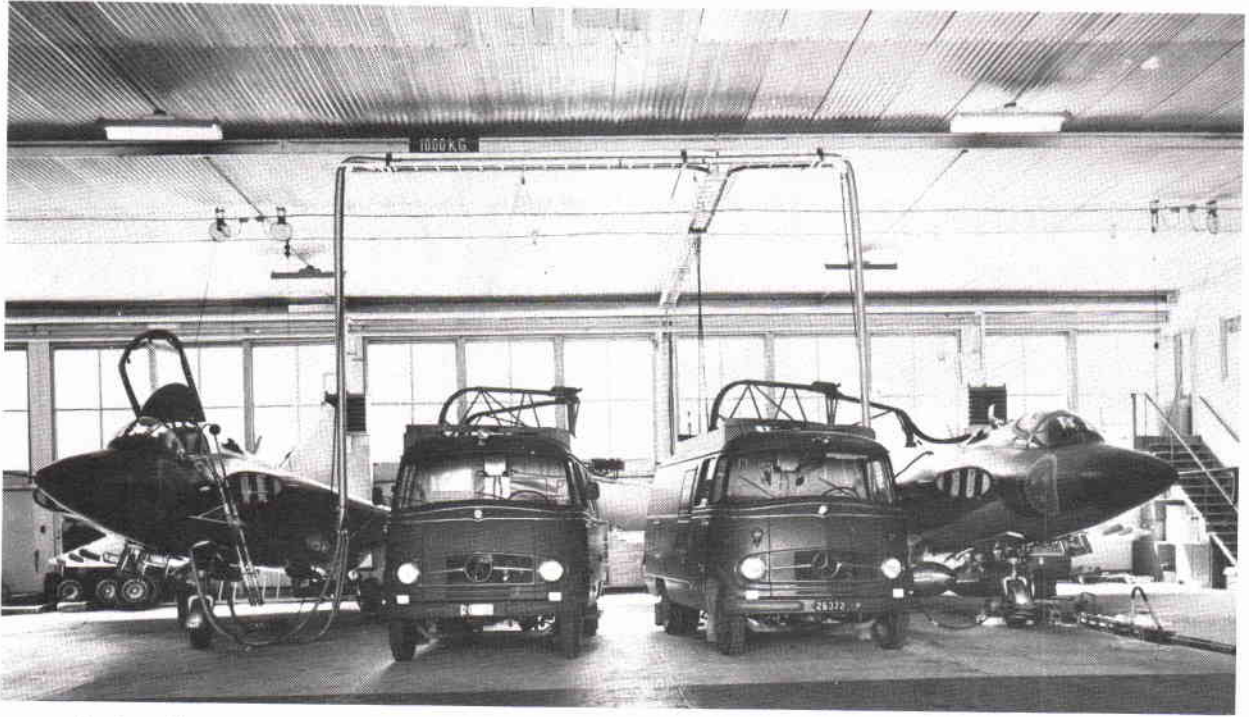
Teleserviceplats vid 1 div F 1. Samtidigt försörjs ett fpl med kylluft, hydraul- och elkraft och ett annat med enbart elkraft. Samtliga ledningar ligger på kabelstegar, varav den för hydraulförsörjning är vridbar, så att endera fpl kan betjänas. Kylluftledningarna är värmeisolerade plåtrör för att skydda taket. F4 använder vanliga avloppsrör av polyeter för kyl luften.
