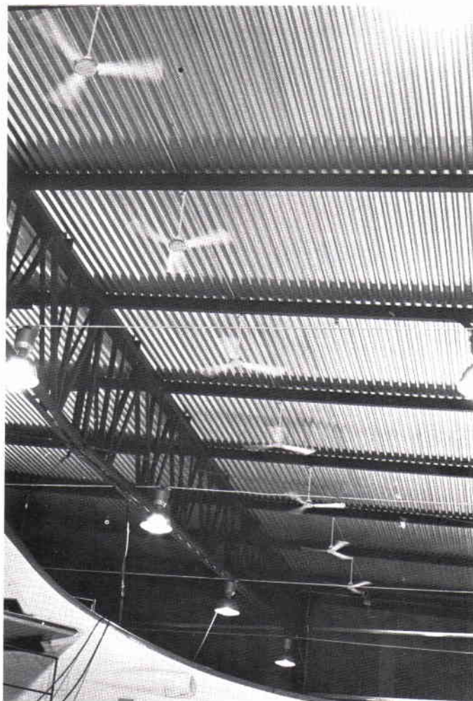
Med fläktar i hangartaket lyckades man få värmen att sprida sig bättre.
