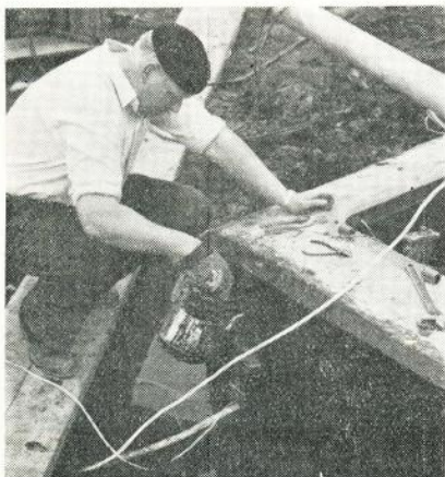
Jonny Evensen fyller på kabelmassa
