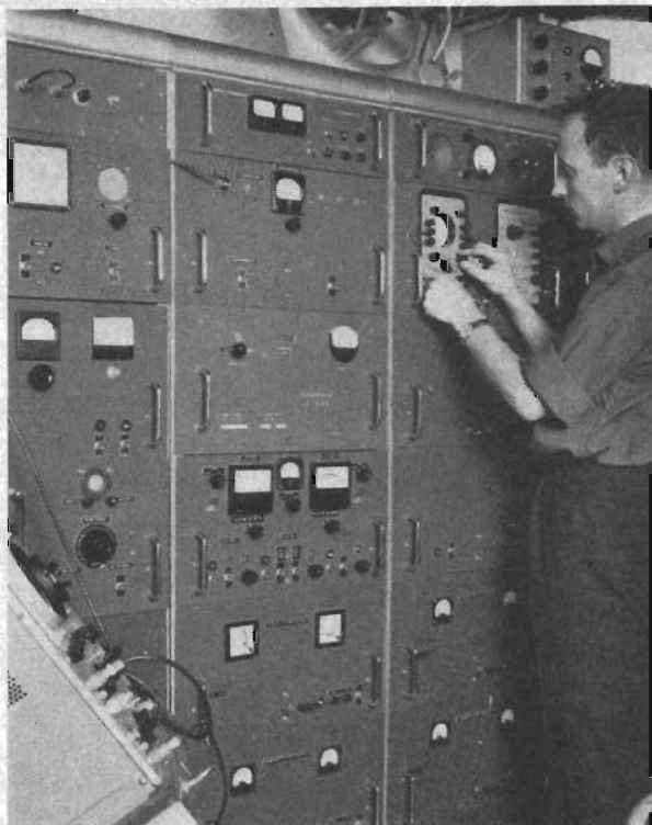
Fig. 3 COMSCA-stationens huvudmottagare i antenntornets första våning. Koaxialkablar förbinder denna mottagare med lågbrusförstärkarna i antennspegelns tubformiga förstärkarrum.
