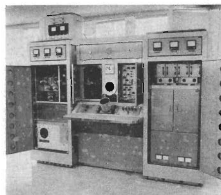
Fig 3. Sändarens framsida. Till vänster sitter den bredbandiga effektförstärkaren och pulsmodularen. Den roterande och lätt avläsbara frekvensskalan är placerad omedelbart ovanför monitorn på mittskåpets framsida. I stativet till höger sitter registreringsdelen med kameror och registreringsrör.
