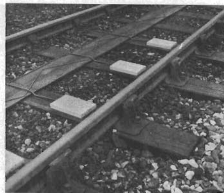
Fig 8. I ett induktivt system för automatisk styrning av tåg ingår två ledningar, en rak och en som lagts i sicksack. De platta enheterna t h i bilden är induktansspolar för överföring av information i form av binära koder.
