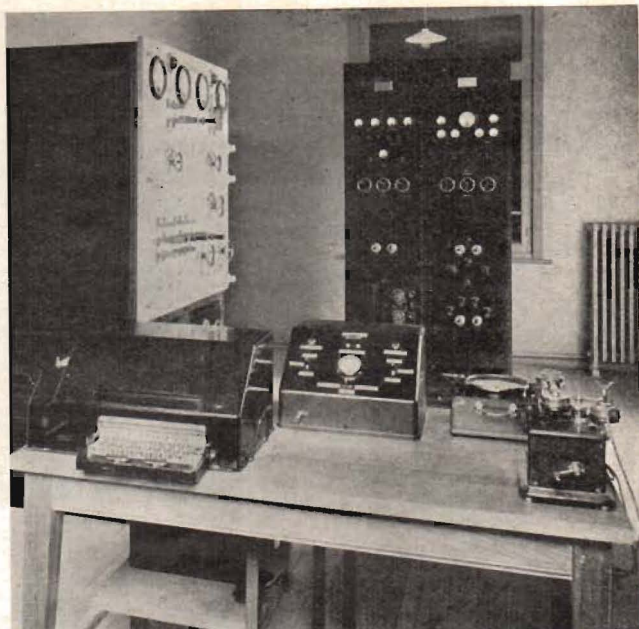
Modern fjärrskrivare, installerad å »mikrolinjen» Lympne—St. Inglevert.
