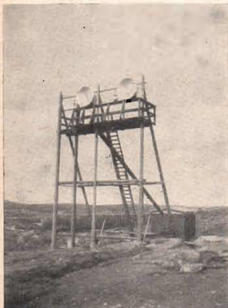
Fig. 1. Riktantennerna för radiolänken Koster—Strömstad är uppställda på 10 m höjd i speciellt uppbyggda träställningar.
