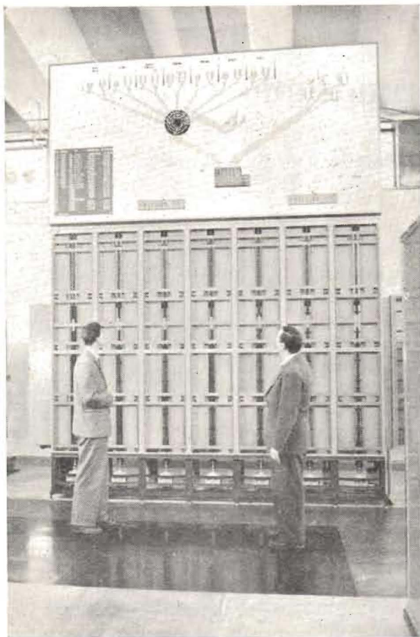
Matarledningsväxeln i sändarhallen. Med denna kan endera av kortvågssändarna kopplas till vilken som helst av de sju matarledningarna som går till antenntornet. Växeln fjärrmanövreras från kontrollrummet.
