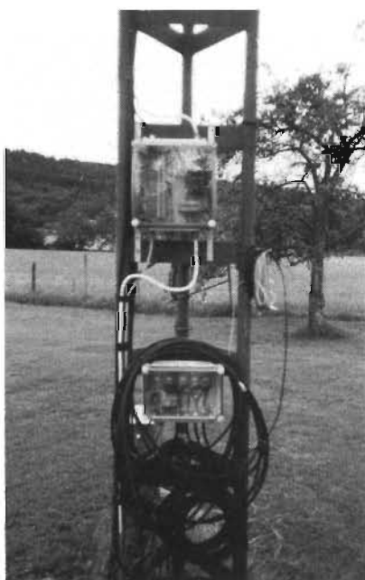
Antennväxel ute vid masten.
