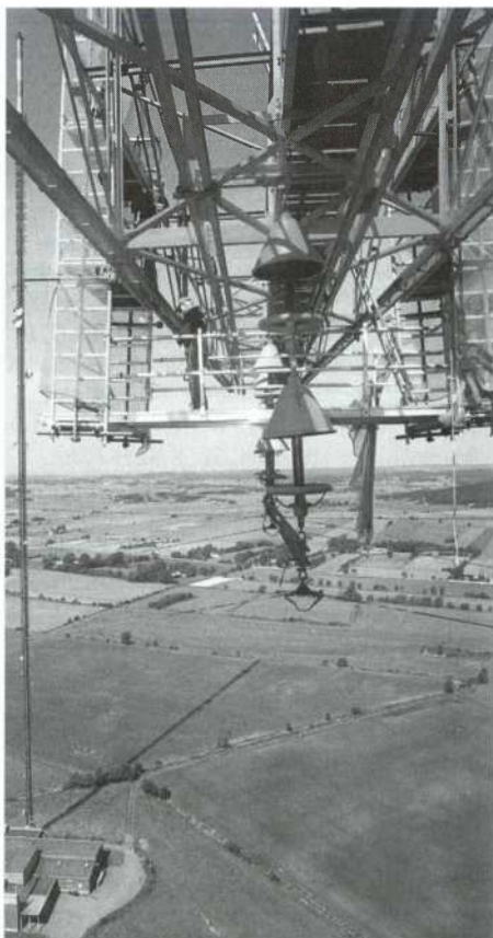
Målning mast 3, FM-TV mast med tillhörande sändarstation till vänster.
