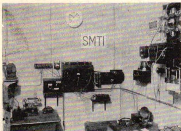
Örebro rundradiostation. (Interiör.) Förstärkare och kontrollanordningar.
