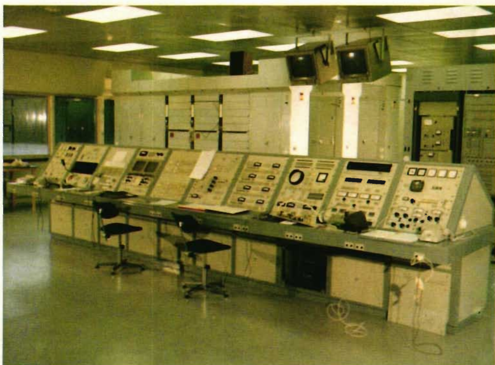
Interiör från kontrollrummet till Tanum-stationen.
