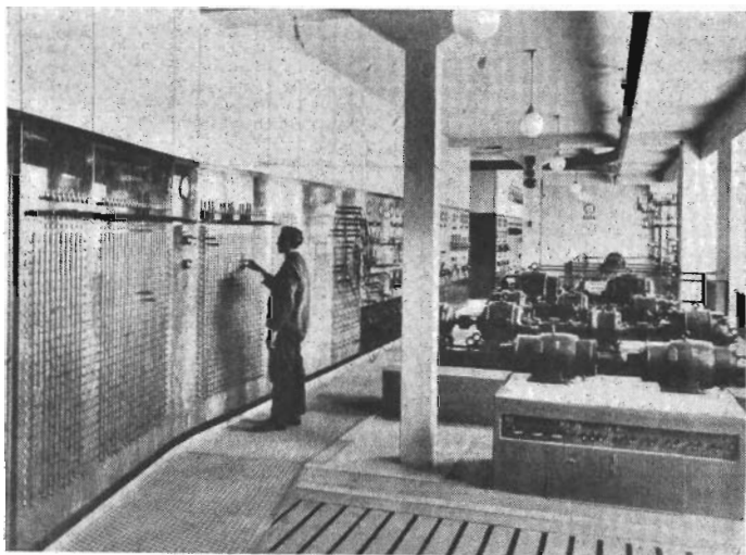
Fig. 2. Institutets stora maskin- och kopplingscentral.
