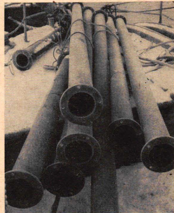
Mammutpumpen sätts ihop av dessa rör. Det är denna pump som suger upp slam och dy 30 m från botten till vattenytan. Tryckluften till mammutpumpen förs in via ett mindre rör, skjuter på luftkudden och får på så sätt igång självsuget.
