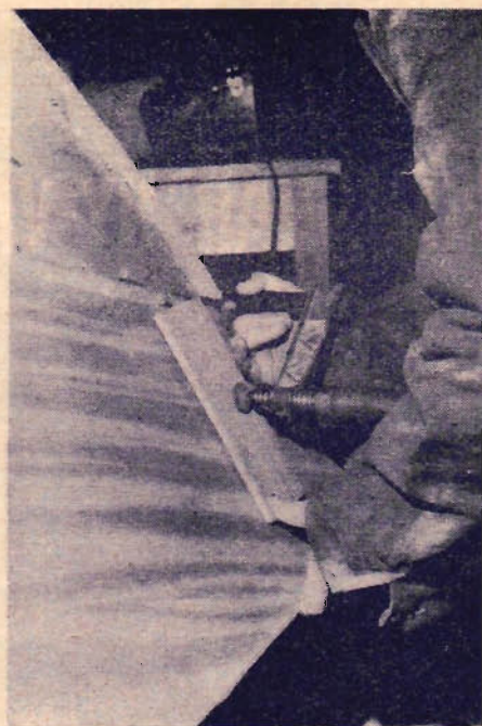
2 Ett av de förliga sidoborden passas in. Böjningen är avsevärd vid fören och det behövs rejäla tvingar för att pressa in det kraftiga plywoodbordet.
