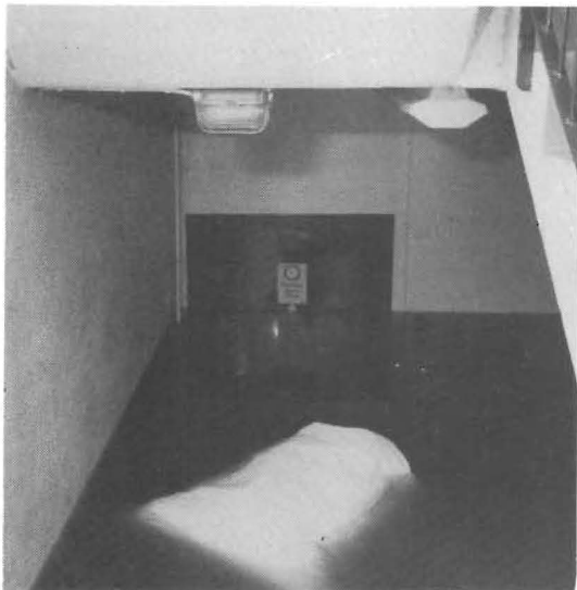
Vare sig behöriga eller obehöriga tog sig in i källaren till byggnad 25. Fram till dörren nådde bara en säck som guppade omkring på vattnet.
