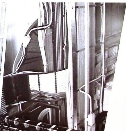
Kablar med olika isoleringsmaterial, bly, textil, plast representerar i form av "kulturlager" olika tiders teknik. Tvt Fotokont. 1985.
