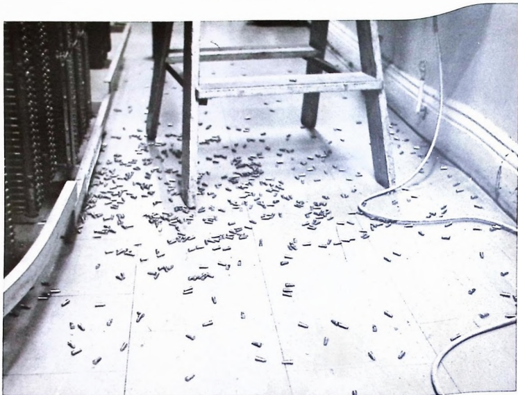
20 000 kortslutningsrullar samlades på golvet när Norra Vasa kopplades bort. Foto K. V. Tahvanainen.
