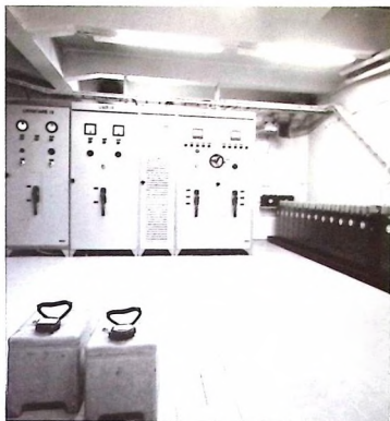
Batterirum i källaren. Tvt Fotokont. 1985.
