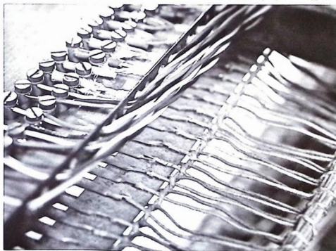
I korskopplingen finns prov på olika tiders kopplingstråd, från bomullsspunnen med bensin till plastisolerad. Tvt Fotokont. 1985.
