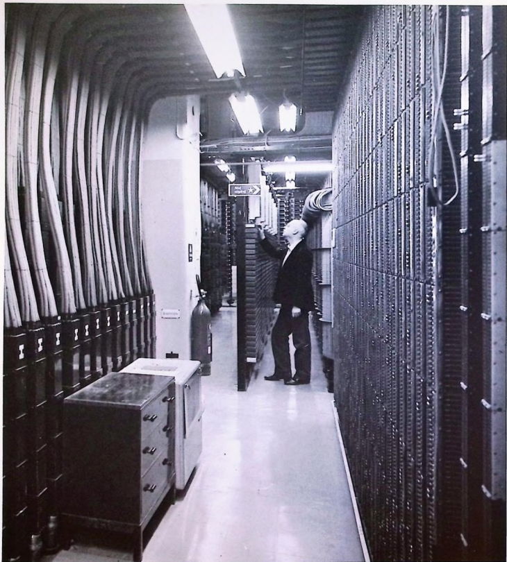
Till vänster slutrörboxar där kablar kommer in till stationen, till höger korskopplingar där abonnentlinjerna förenas med de olika telefonnumren. Tvt Fotokont. 1985.
