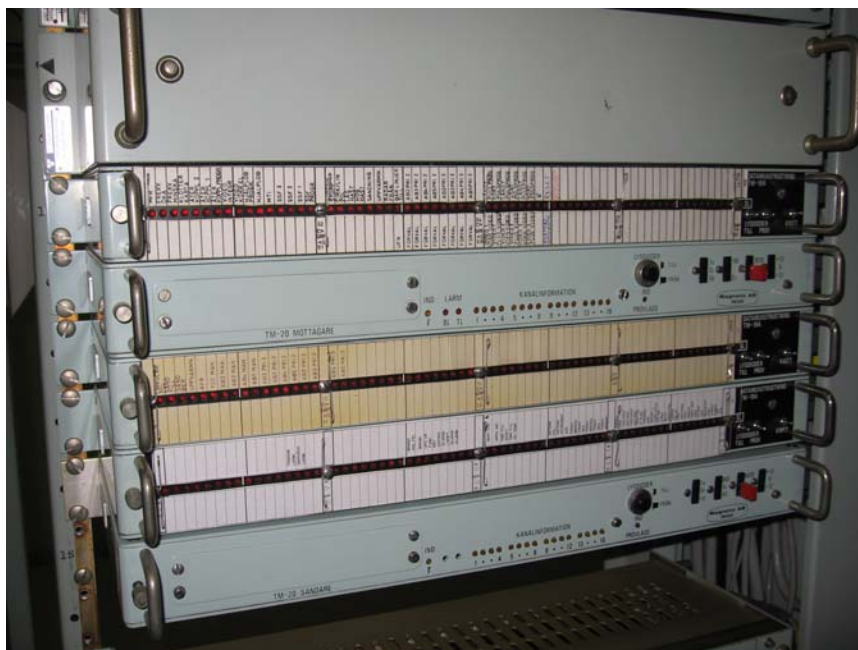
Figur 5: Övervakningsutrustningen på en PS-810 anläggning
