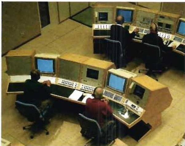
Ledningscentralen vid RFN i Vidsele.
