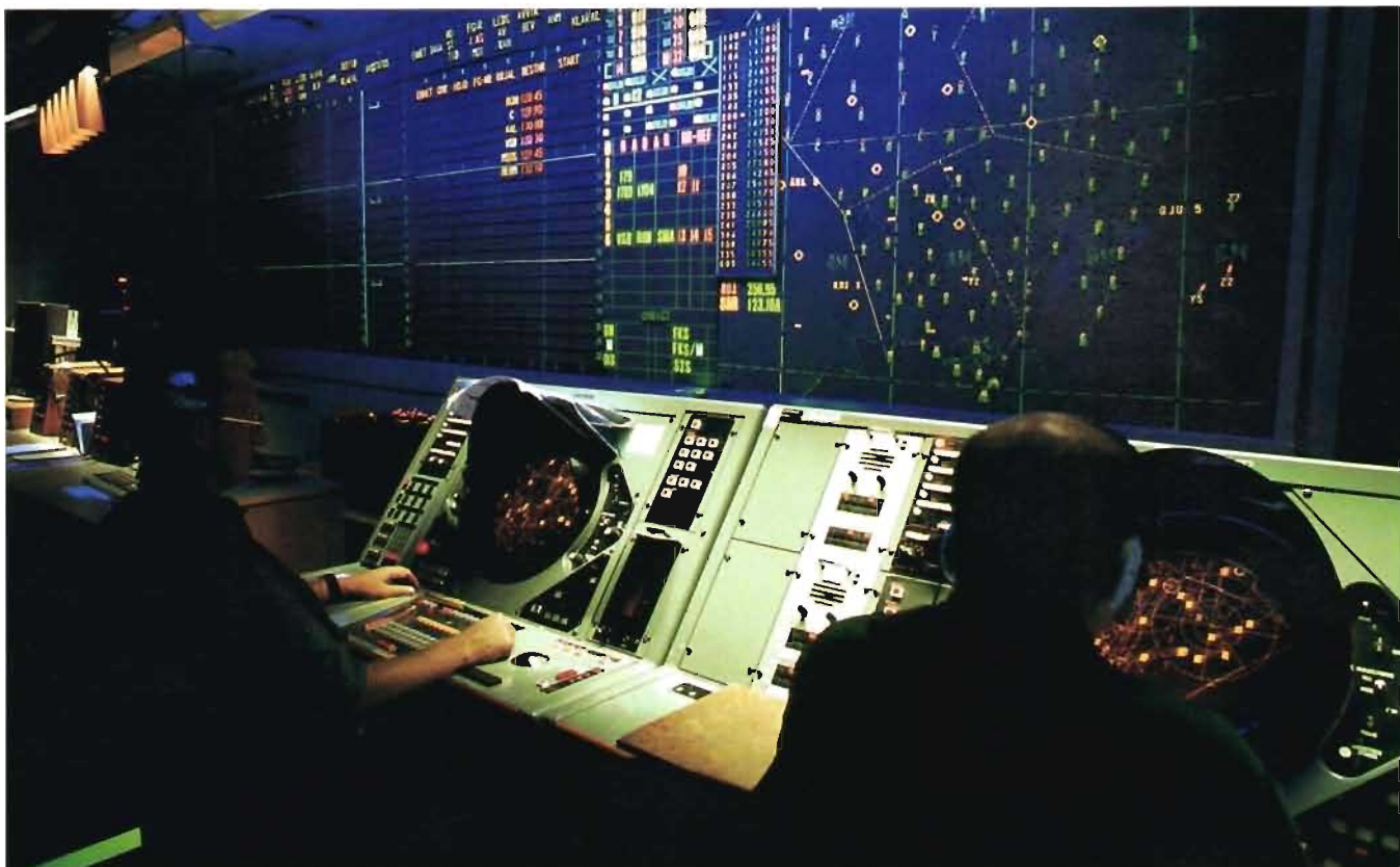
Ledningsrummet i radargruppcentralen Myran var under många år en centralpunkt för luftbevakningen och incidentberedskapen av sydöstra Sverige.
