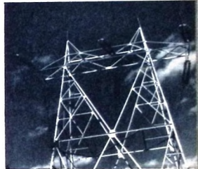
Kraften från Järpströmen transporteras till mellersta och södra Sverige på 200 kV-ledningar.
