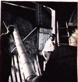
En fläkt med rör av masonit i arbete på Råsta Gärd.
