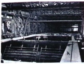
Den ännu inte färdiga doppanordningen i vilken man kan sänka hela karosser i olika bad för avfettning, syrabehandling, tvättning etc. Anläggningen är över 60 meter lång.
