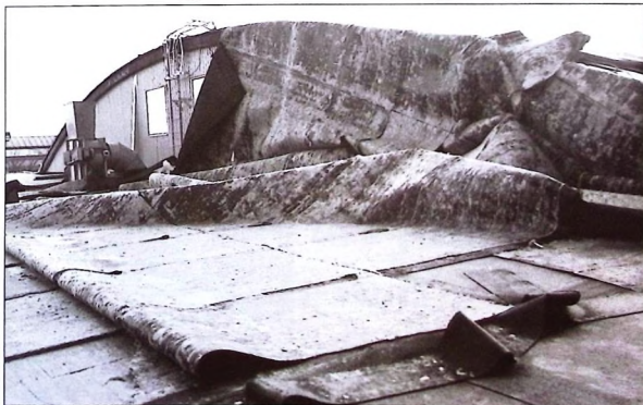
Så här såg det ut på nattetill en av hangarerna vid division Flygteknik efter helgens storm. De kraftiga vindarna slet loss del av taket på den nyare delen av A-ballen.
