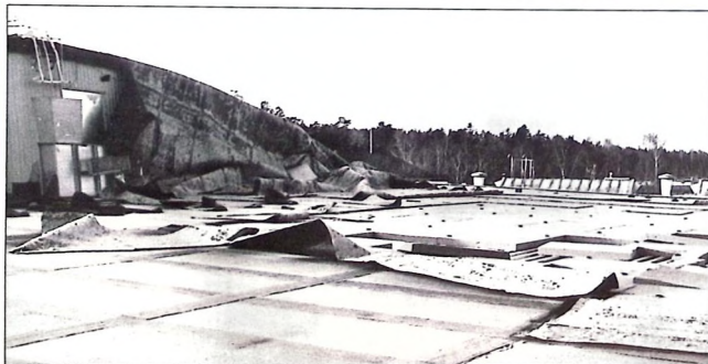
Den senaste vindkraftstornet slet loss en del av taket på nya A-hallen i Linköping. Med skadeförsäkring inskränker sig FFV Aerotechs kostnader för reparation till självrisksbeloppet.
