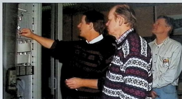
En fullpackad datorack utgör JAPSEs hjärta och förbindelselänken i kommunikationen mellan CD och elektroniska systemen i division Systemteknikens testrigg JA37 i Arboga. Där kommer systemet att vara placerat även i framtiden.
