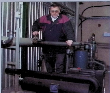
Roland Trinks har skaldat nedanstående rader om de nya vakuum-pumpar som nyligen installerats på ett par håll i Linköping.
